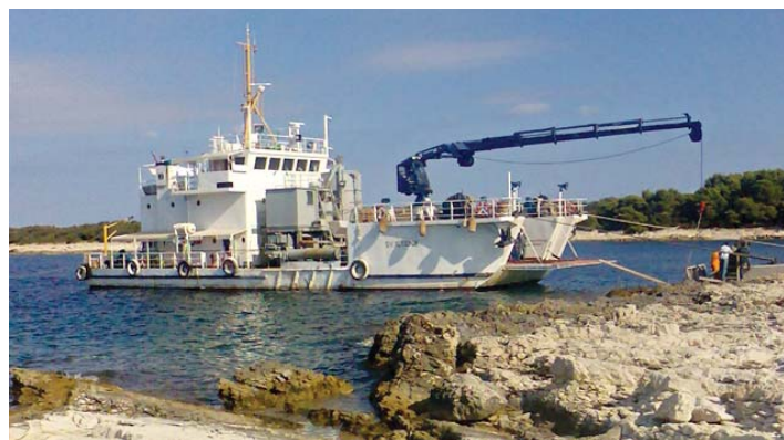
Brod radionica "Svjetionik" (1987.): betonara, trajekt, vodosprema, dizalica, podvodni radovi, ronionci i dr. / Schiffswerkstatt „Leuchtturm“ (1987): Betonfabrik, Fähre, Wasserschloss, Kran, Unterwasserarbeiten, Taucher und Anderes
